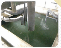
地下にある中水槽。雨水やドレン水（エアコンの室外機から出る水）がここに集まってきます。
