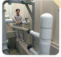
建物の外にある非常用備蓄水槽。災害時に配水管が壊れても水槽内の水がもれ出ないような構造になっています。
