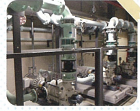
屋上の上水槽に水を送るポンプ。故障などで1台のポンプが止まっても、上水道の水压で屋上の上水層へ送る仕組みになっています。
