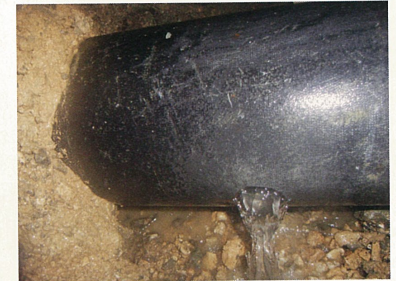
水道管破損状況
